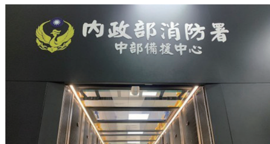
圖 19、資通作業中心中備機房
